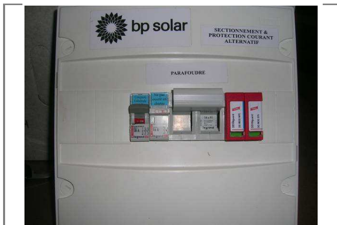
Figure 20. Coffret AC en position fermée.
