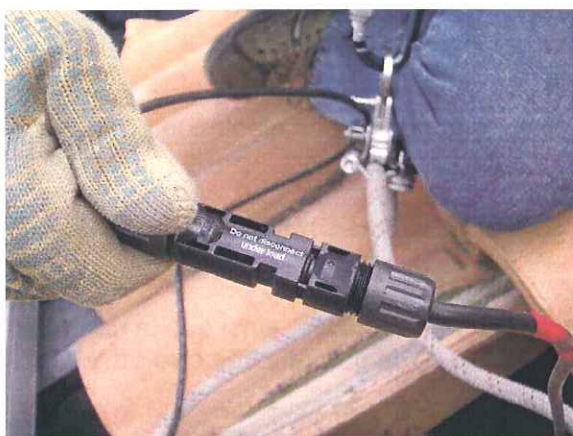
Connecteur MC4 mal verrouillé
